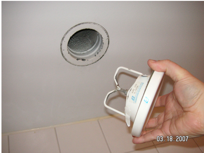
Figur 2 Hela ventilen är loss
